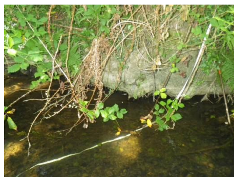
Présence d'une sous-berge
