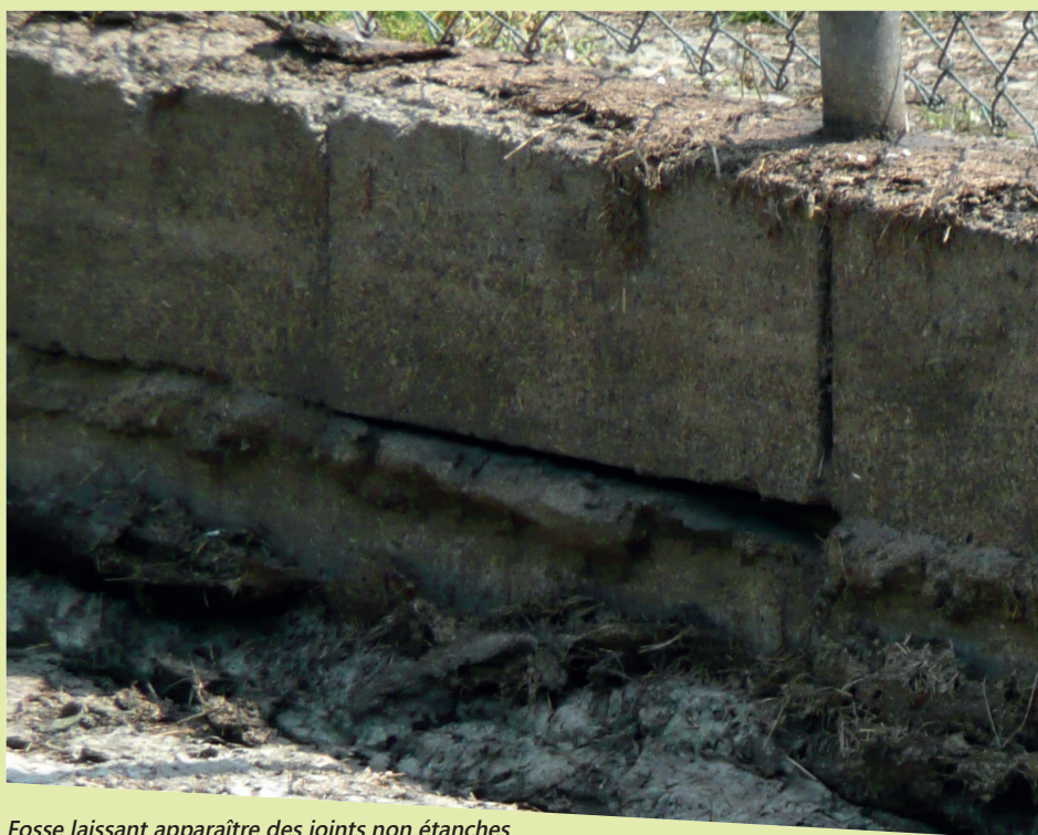
Fosse laissant apparaître des joints non étanches
