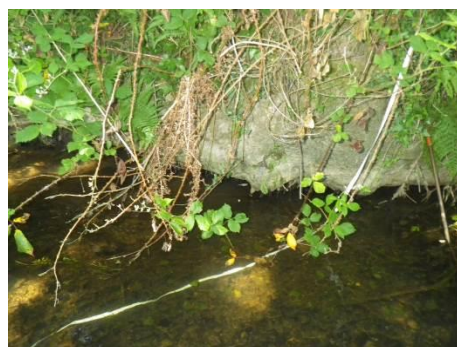
Présence d'une sous-berge
