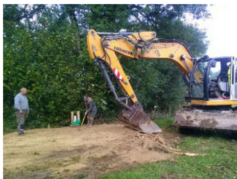
Aménagement d'une pompe d'herbage
