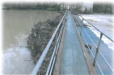
Embâcle menaçant une passerelle
