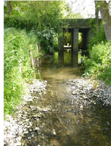
Ennoïement d'un seuil de pont
