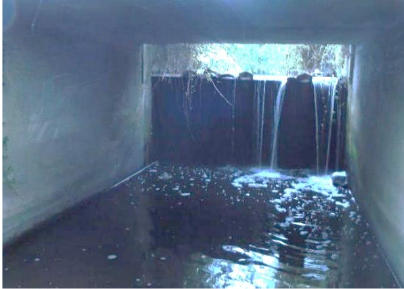
Clapet hydraulique (source : Bassin de l'Oudon)
