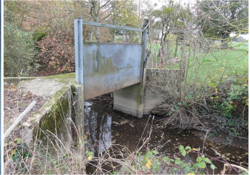
Vanne levante (source : Bassin de l'Oudon)
